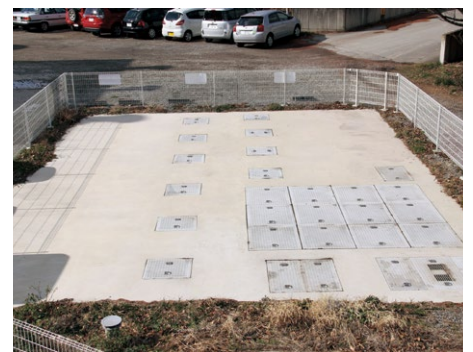
ばっ気槽、膜分離槽
