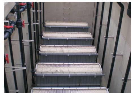
液中膜ユニットの設置状況
