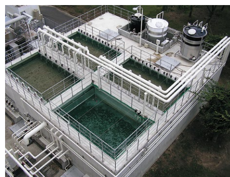
膜分離槽全景
