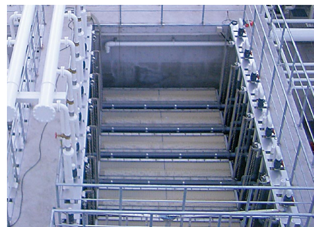
液中膜ユニット設置状況
